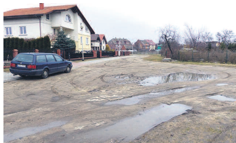
Jak widać modernizacja tego terenu jest nieodzowna. Mieszkańcy na pewno odetchną z ulgą.
