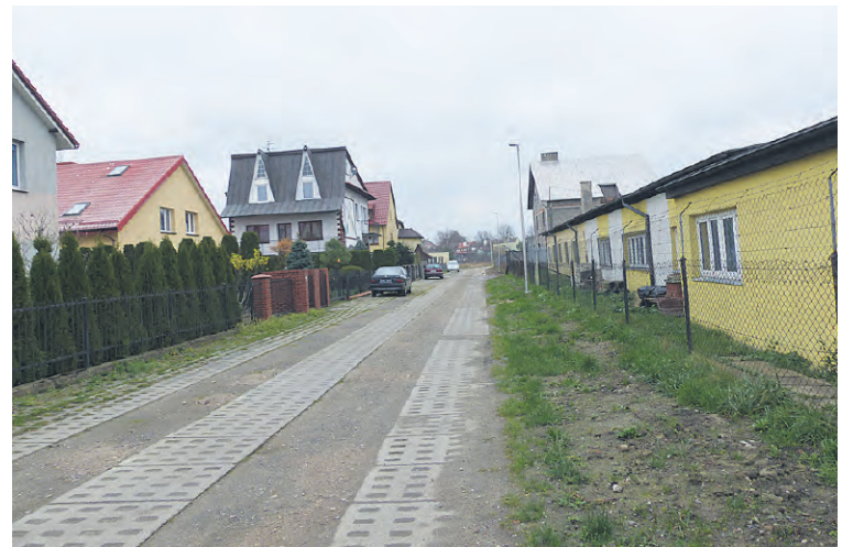
Oświetlenie na ul. Brzozowej, Wierzbowej i Przemysłowej oraz zjazd na ul. Wiśniowej.
