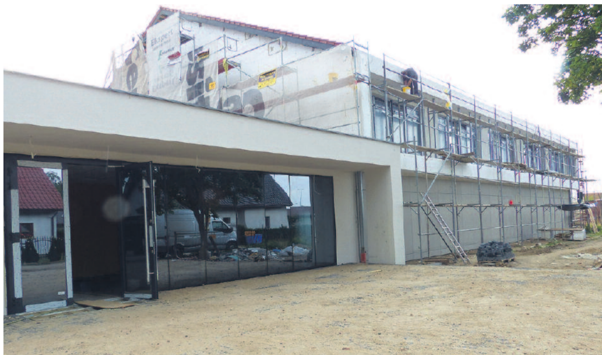
Przyszła hala przy podstawówce ma wyglądać podobnie do tej obecnie budowanej przy liceum.
